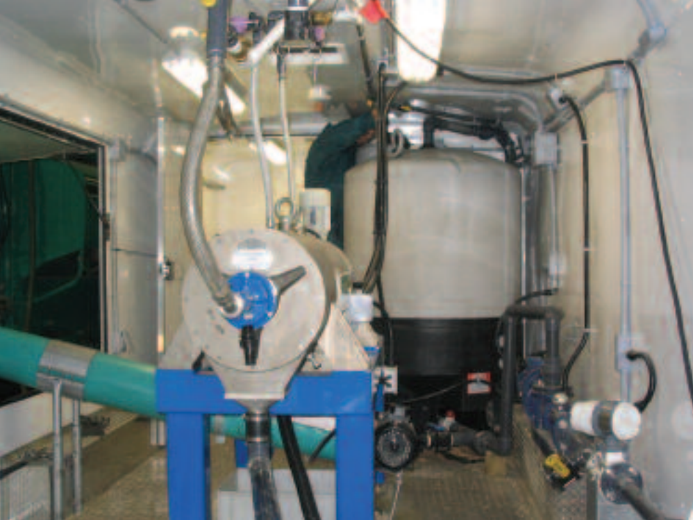
Vue intérieure de l'unité mobile de séparation.
