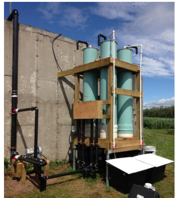
FIGURE 1 : PHOTO DES BIOFILTRÉS
