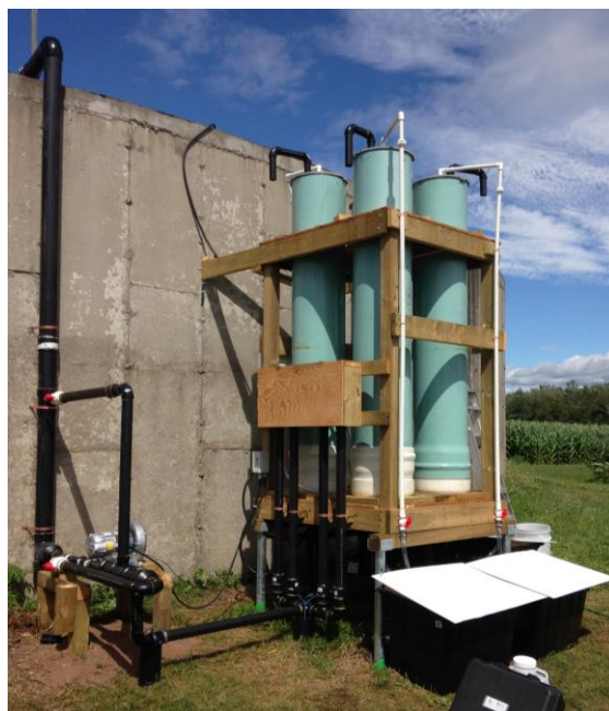
FIGURE 1 : PHOTO DES BIOFILTRES
